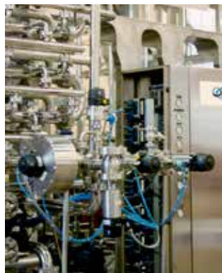
Grupo válvulas de reciclado
